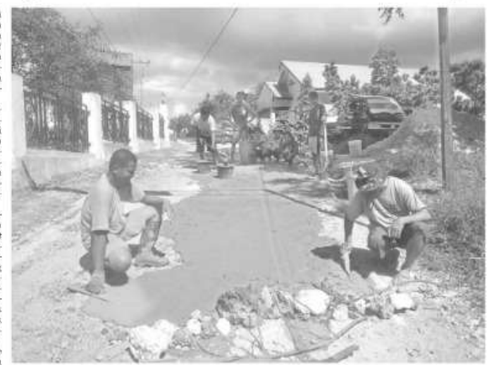
PERBAIKI Warga RW 10, Kelurahan Katalak, Kecamatan Aik, Kota Kupang memperbaiki jalan yang rusak di wilayah itu, Minggu (14/4/2019).
